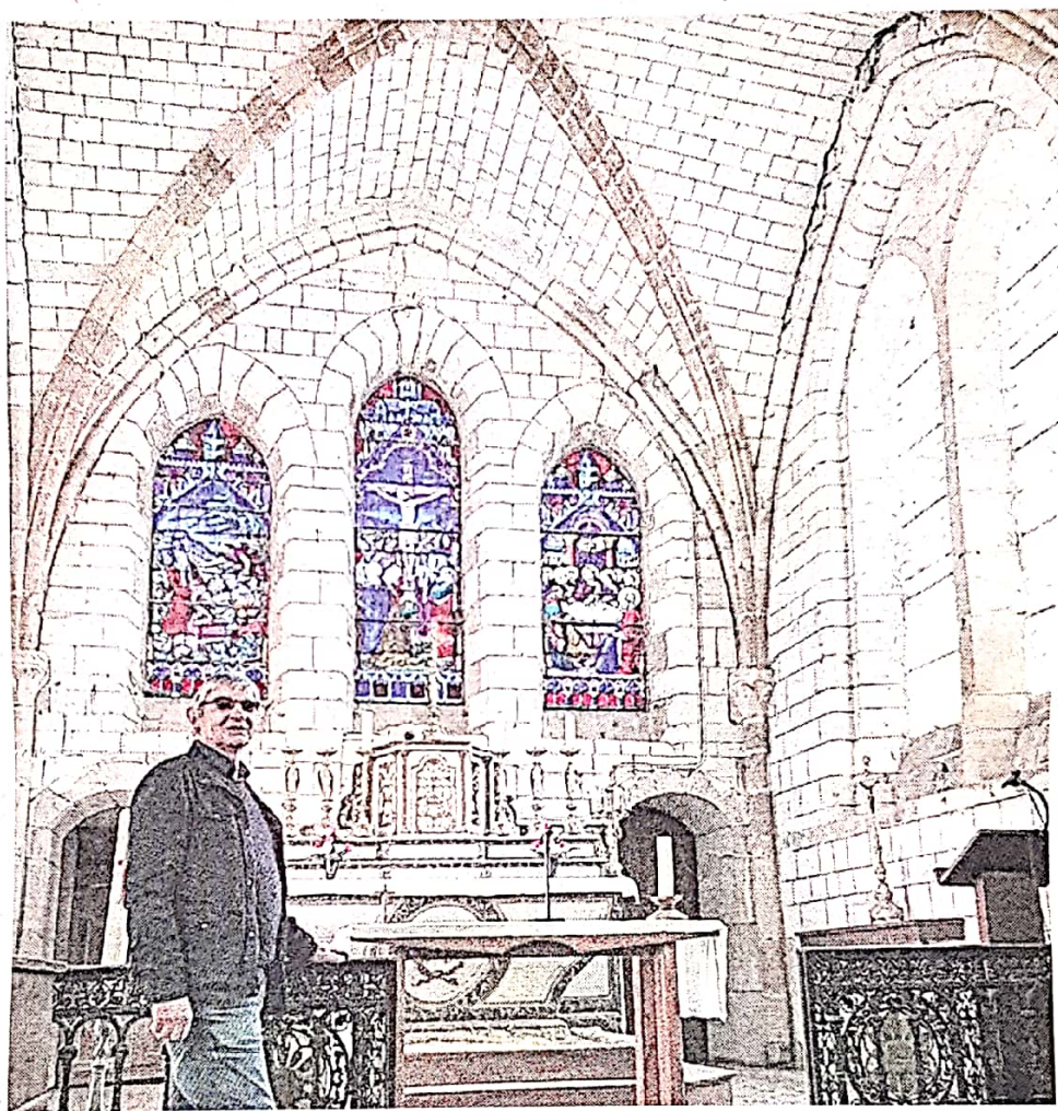
Les fissures visibles à la jonction du mur et de la voûte inquiètent le maire, Michel Nicomette.
